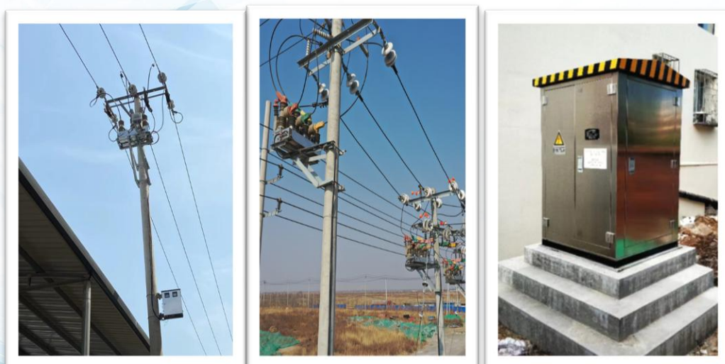
高压费控计量装置现场安装实景照片
